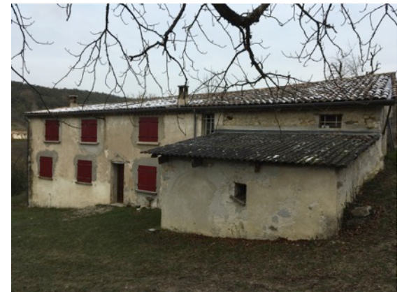
Crest, ..trop tard pour les fenêtres... mais pas pour les problèmes d'humidité
