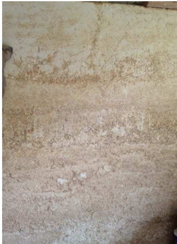
Aspect après décoffrage quelques jours après
